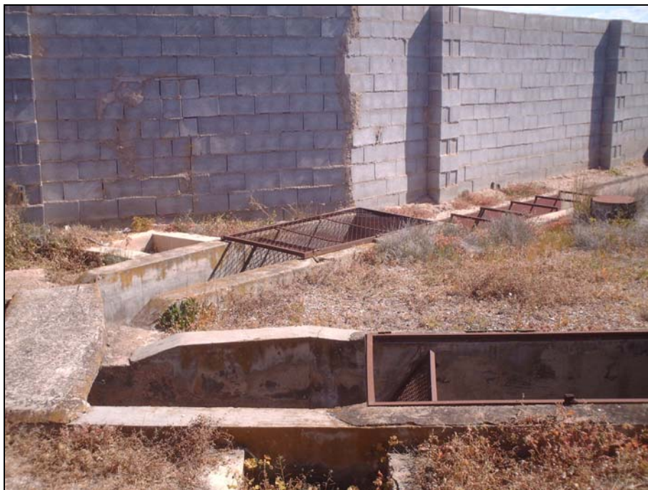
Fotografía 7. Medidor Parshall de la hidrometría de la fuente de Isso.
