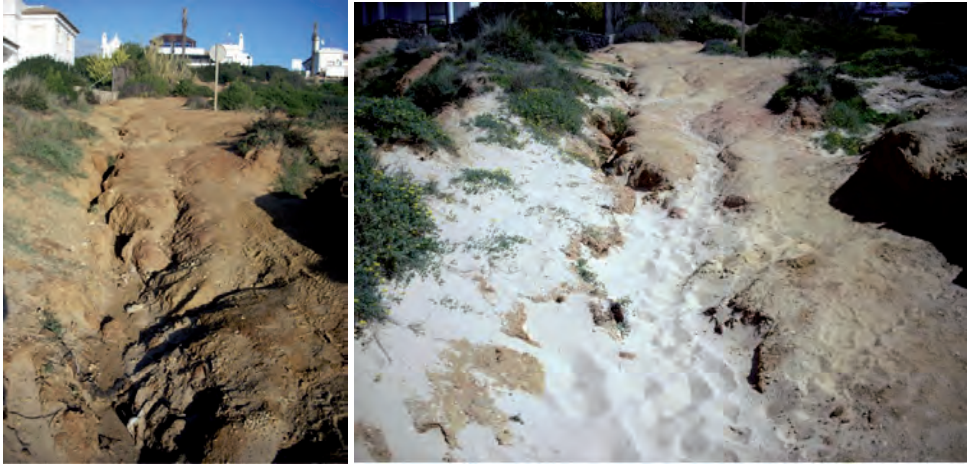
Figura 2: Reguero desarrollado sobre margas y arenas pliocenas en el acantilado bajo de la urbanización Roche, en la playa del Puerco (Conil). Izquierda: incisión ligada al trasiego de bañistas en la bajada de acceso a la playa (invierno de 2008). Derecha: relleno eólico del mismo reguero por arena eólica procedente de la playa (primavera de 2009).
