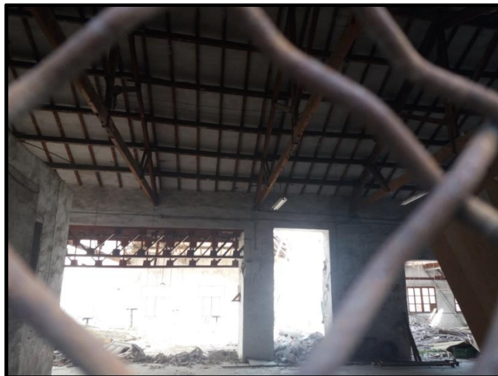
Foto 11: Antiguo almacén de fruta en estado de ruina en el centro de Abarán. Foto propia
