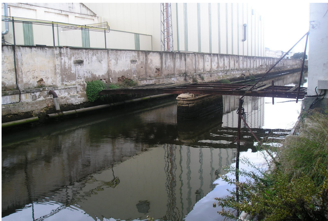
Imagen 15: Canal para enriar maderas. (Foto: Vicente Ruiz García) Una vez que los palos llegaban al arsenal permanecían sumergidos en agua salada para adaptarse al medio marino para el que iban a emplearse. Arsenal de la Carraca
