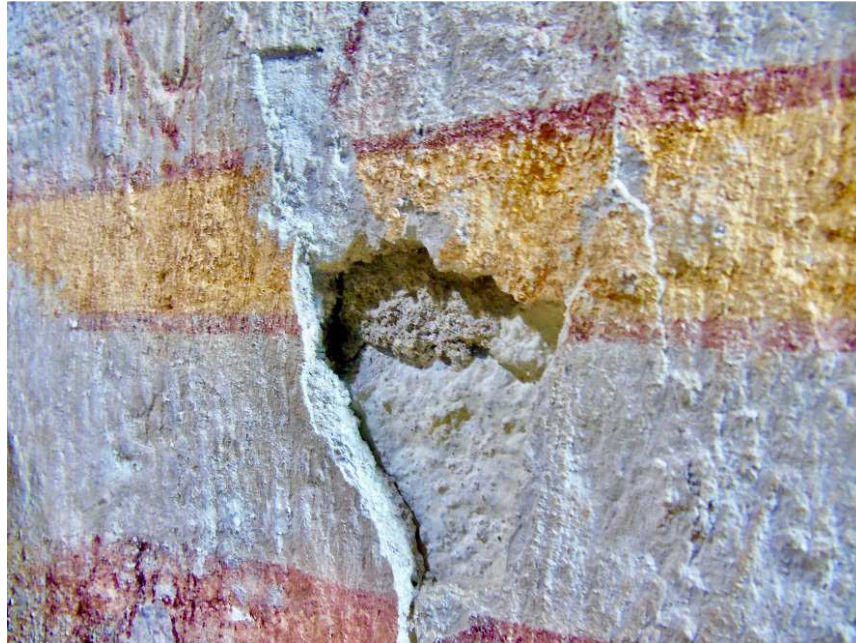
Fig. 5: Segmento de mural dañado en la capilla de los Reséndiz. Fuente: Imagen de la autora, 2017.
