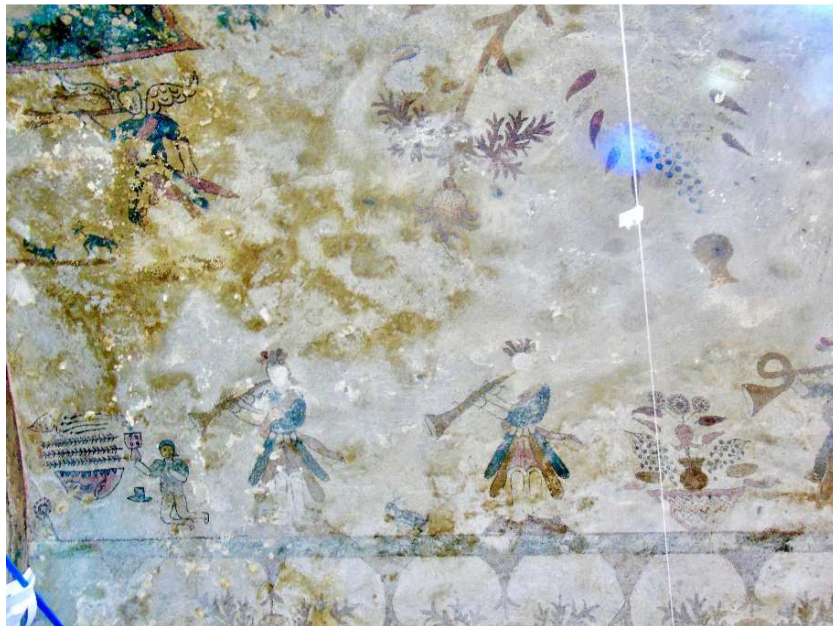
Fig. 12: Humedad por condensación, capilla de los Reséndiz. Fuente: Imagen de la autora, 2017.
