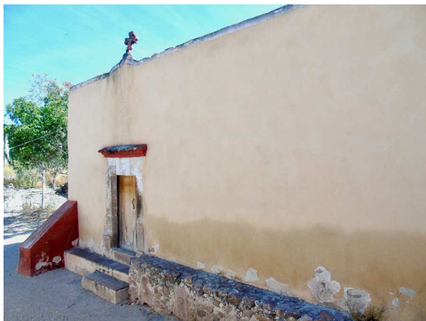
Fig. 11: Humedad ascendente en la capilla de San Diego. Fuente: Imagen de la autora, 2017.
