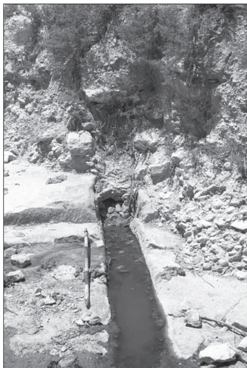
FIGURA 110. Wādī Ŷurum . Boca de acueducto casi cegada
