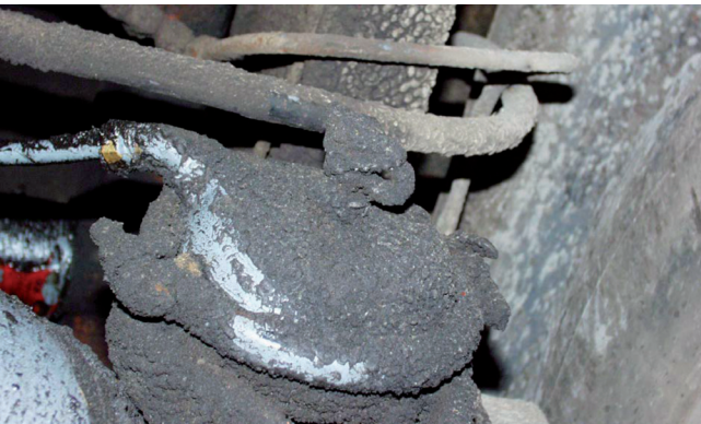
Figura 13: Toma de presión deteriorada
