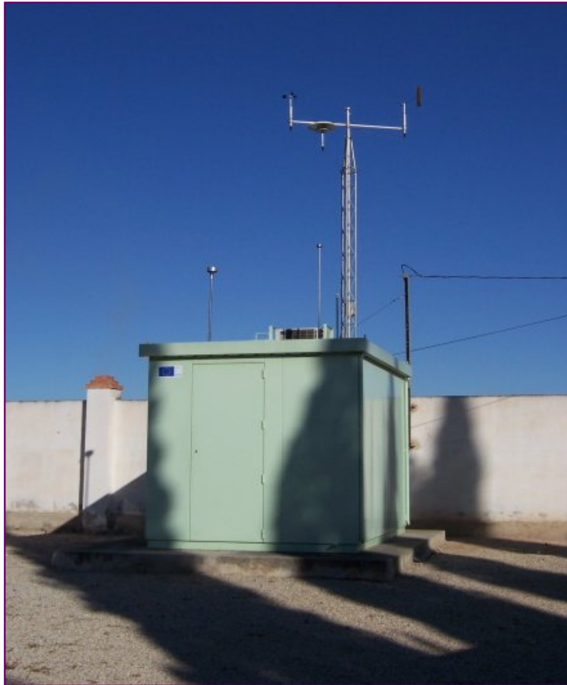
Figura IV.1.2.1 – Estación de Vigilancia Atmosférica de Alcantarilla, Murcia (España).
