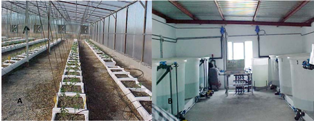
Figura 16. Aspecto general del sistema de riego por depósitos y del invernadero donde se han realizado los experimentos a largo plazo de estrés salino e hídrico de tomate.
