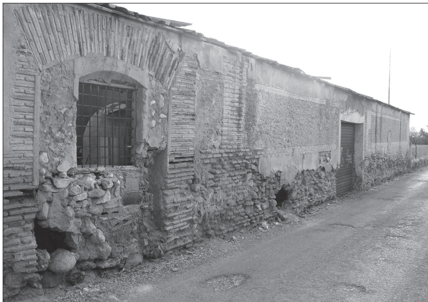
FOTO 1. Estado actual de la fachada de la almazara. Crujía oeste de la antigua Posada de Librilla.
