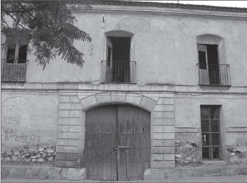
FOTO 3. Portada de carruajes oriental con fábrica sillería de cantería con suave almohadillado. Presenta defensas en la base y esviaje de las jambas.
