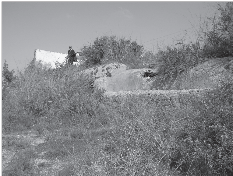
FIGURA 8: Depósito en el que se reunían las aguas de San Juan y las del Calvario. Cartagena. Se aprecia en primer plano una rotura de la bóveda.
