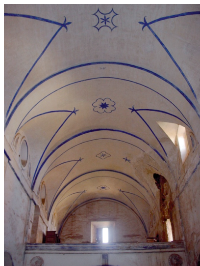
Fig. 4. Bóvedas de la iglesia, con fajones y lunetos, restauradas en 1876.
