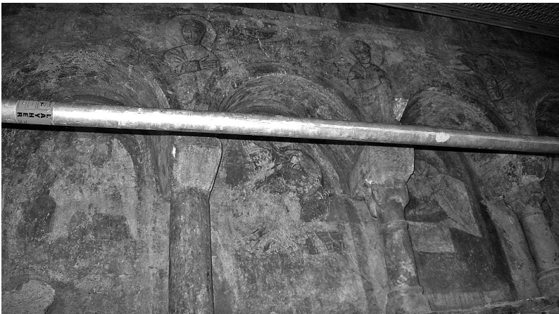
Lámina 3: Fotografía del detalle de los nichos del altar tomada en febrero del 2009 en condiciones poco propicias debido a las obras.
