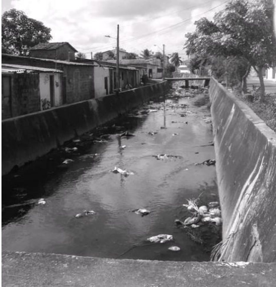
[Figura 1. Esgoto aberto situado no bairro Pan-Americano.]
