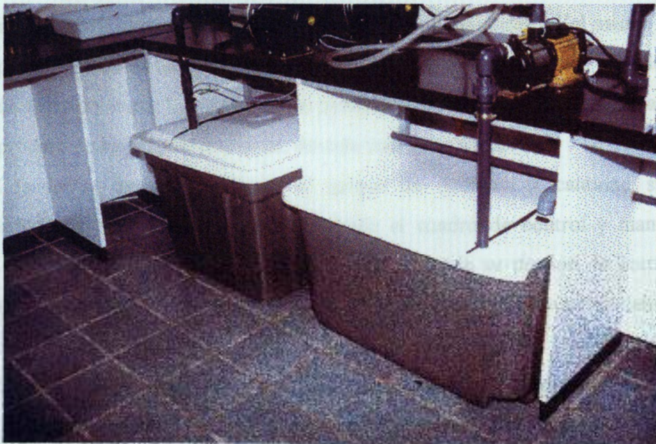
Figura 4.2 Depósitos, de desecho conectado a la bomba de recirculación, y de producto y mezcla conectado a la bomba de elevación a los depósitos de alimentación.
