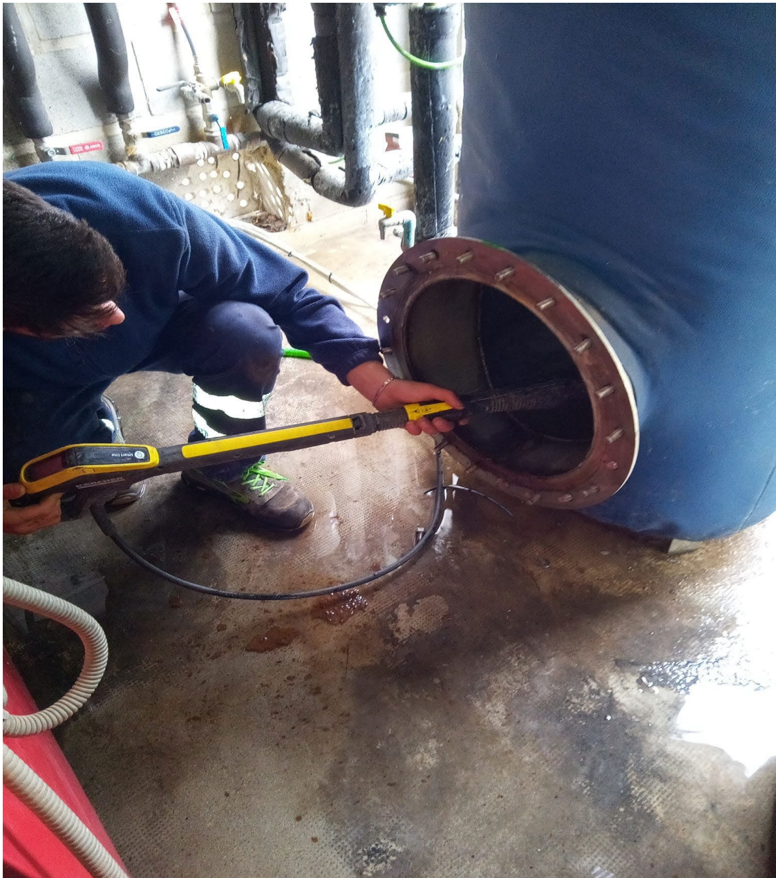
Figura 22: Procedimiento de limpieza y desinfección de acumulador de agua caliente sanitaria según R.D. 487/2022. Fuente: Autor.
