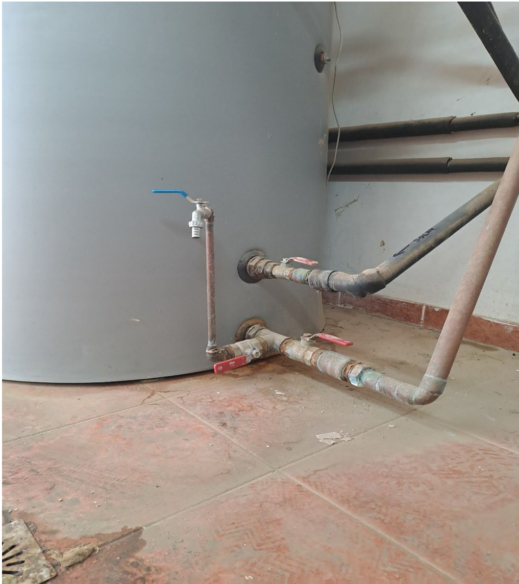
Figura 25: Purga de acumulador de agua caliente sanitaria. Fuente: Autor.
