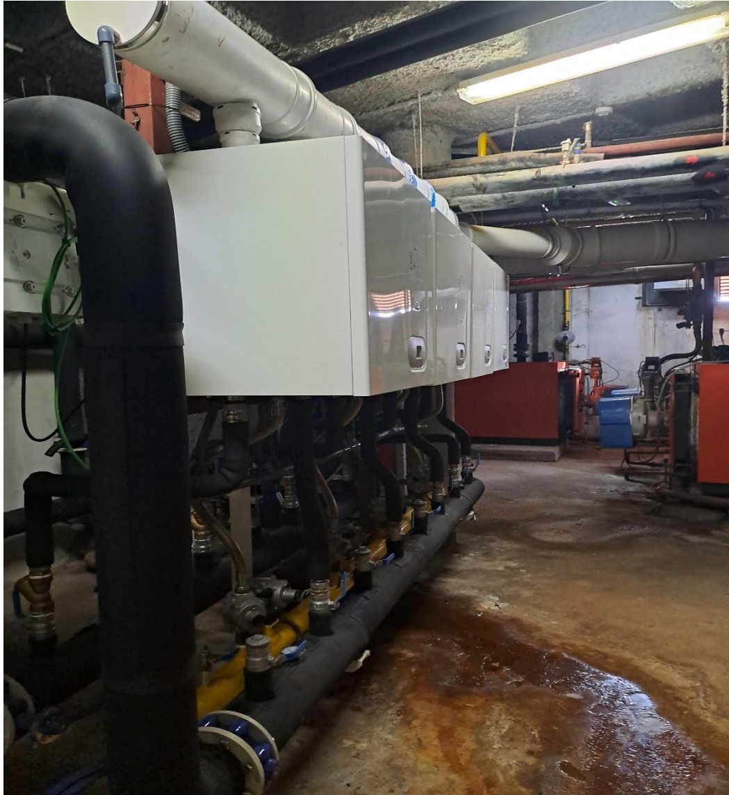
Figura 29: Calderas de circuito primario. Fuente: Autor.
