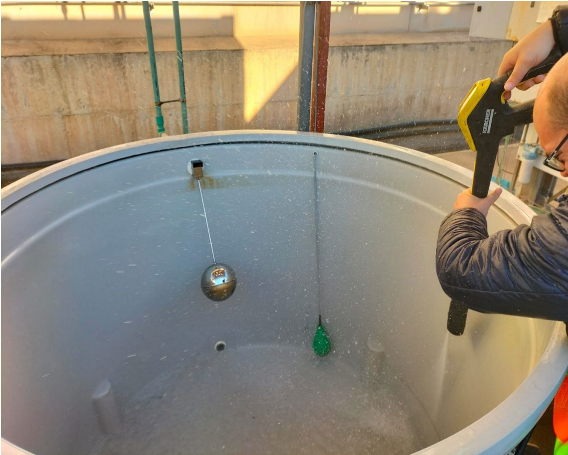
Figura 23: Procedimiento de limpieza y desinfección de una E.T.A.P. según R.D. 487/2022. Fuente: Autor.
