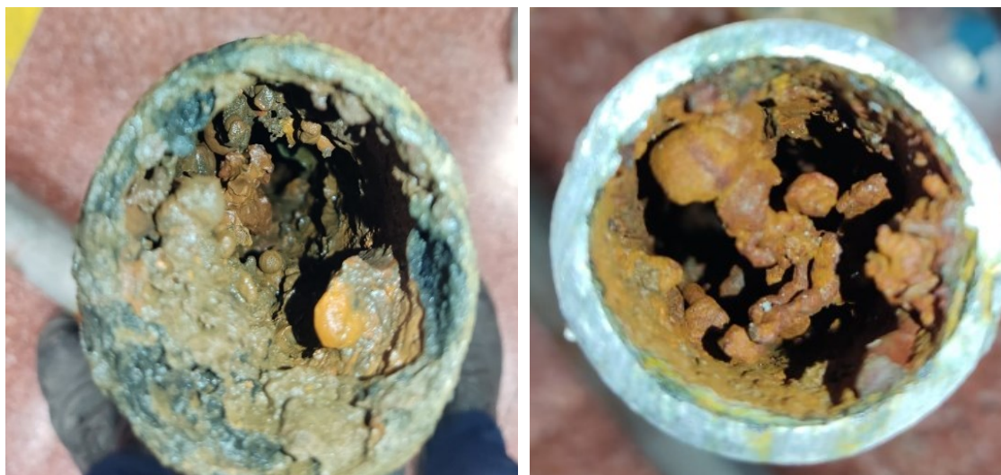
Figura 55. Detalle fotográfico de diversos puntos de estado interior de la red de tuberías sustituidas.
