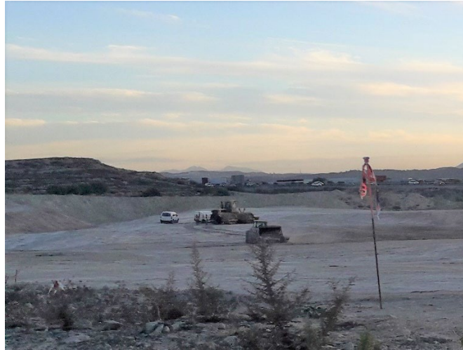
Figura 1.3.3. Compactación de suelo por maquinaria pesada
