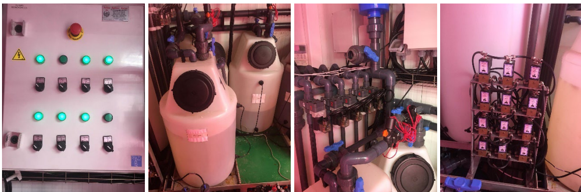
Ilustración 6: Imágenes que muestran el cuadro eléctrico, los depósitos con las soluciones madres para realizar solución nutritiva, los contadores y las válvulas de riego.
