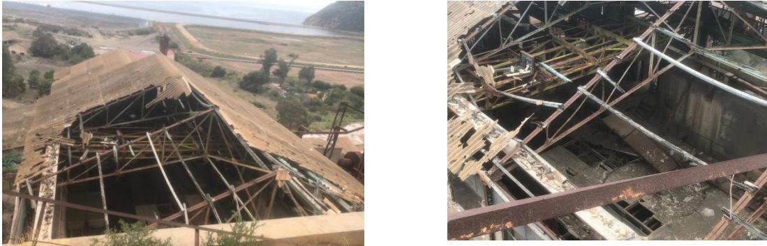
Figuras 19 y 20: Estado actual del lavadero. (Elaboración propia)
