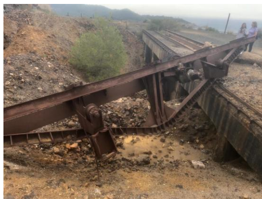
Figura 18: Estado actual de la antigua vía que conectaba el túnel José Maestre con el lavadero Roberto. (Elaboración propia)
