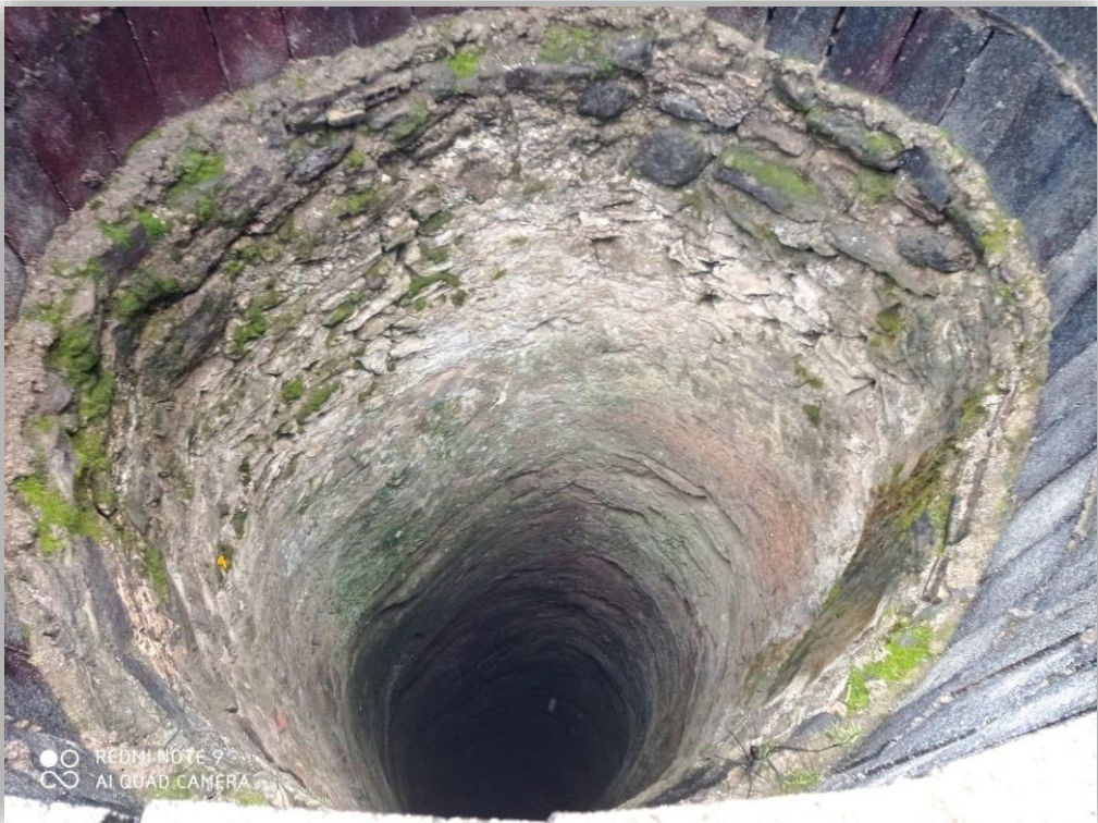
Figura 72: Imagen del interior de un pozo minero en las proximidades al núcleo urbano de El Llano del Beal, año 2021.
