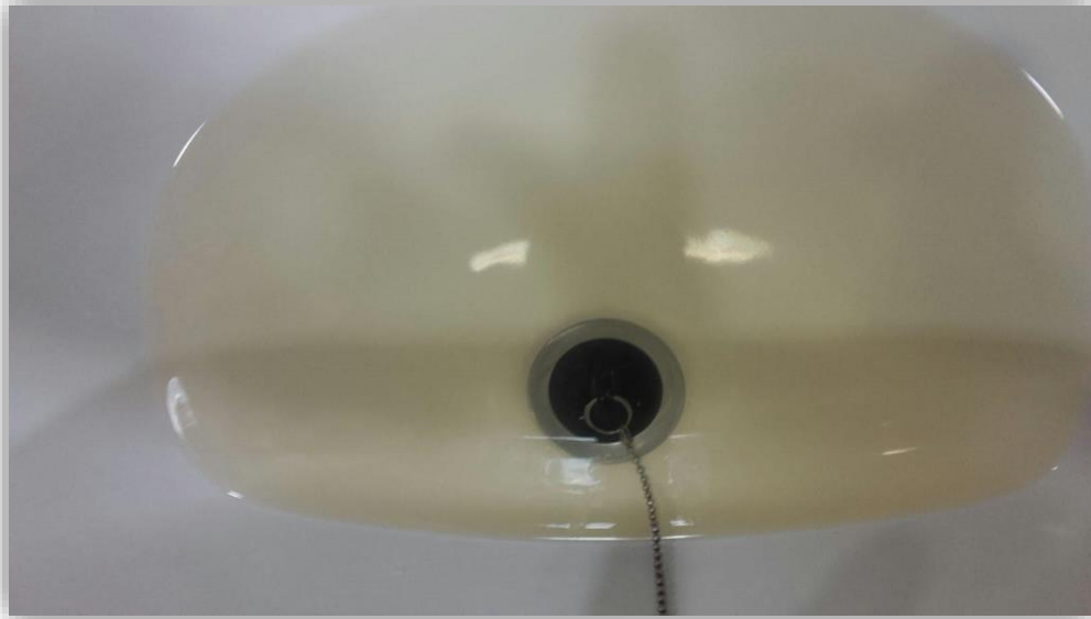
Figura 73: Lavabo de una vivienda de El Llano donde sale agua turbia procedente de la red de agua potable, año 2017.
