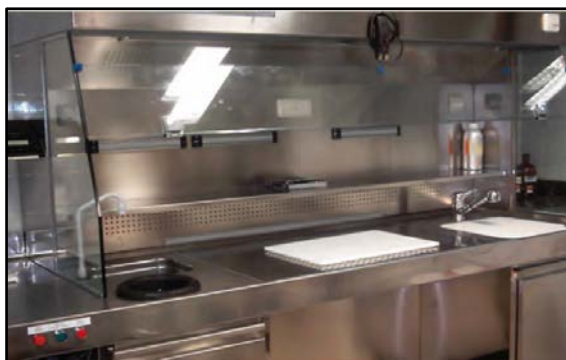
Figura 24. Mesa de tallado, dotada de extracción localizada.
