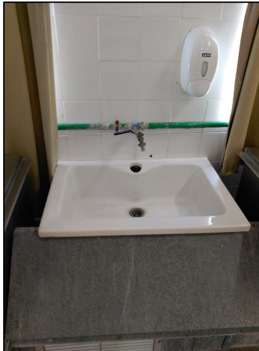
Figura 18. Lavamanos ubicado en la sala de prácticas.
